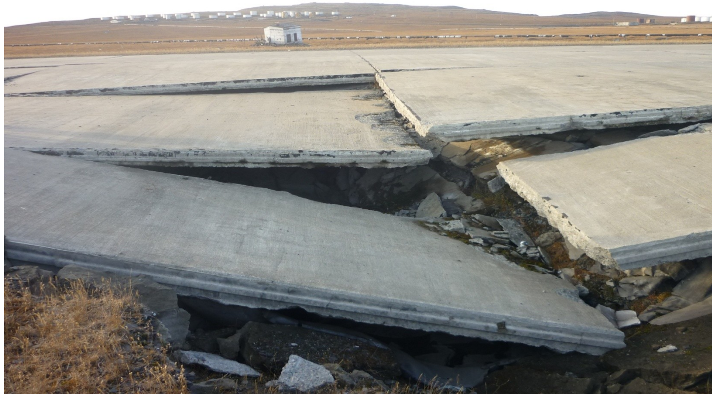
Растепление и вымывание основания покрытия РД
