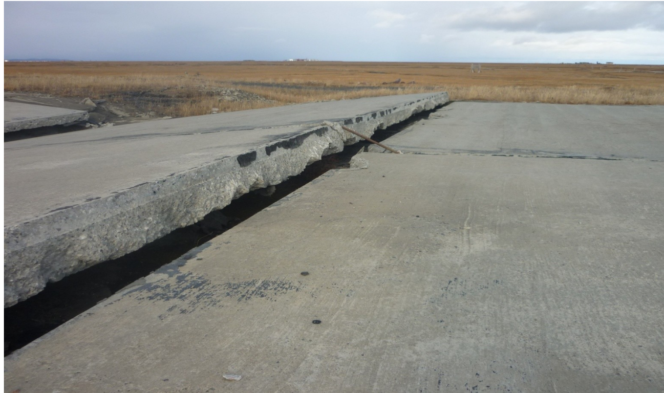
Вымывание основания покрытия РД
