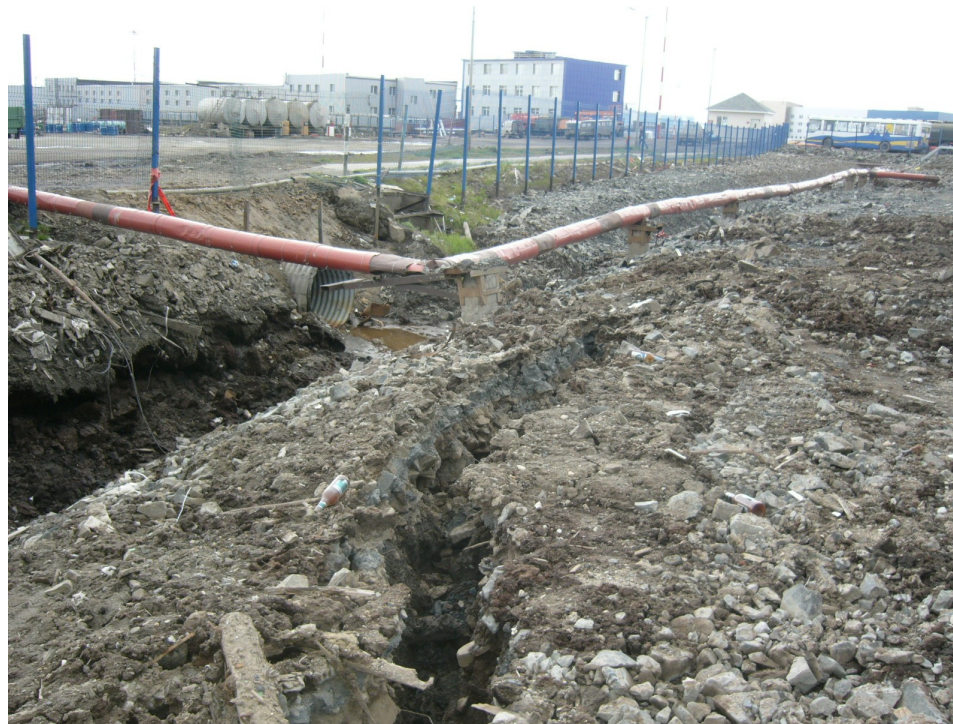
Оползневые разрушения правого борта водоотводной канавы
