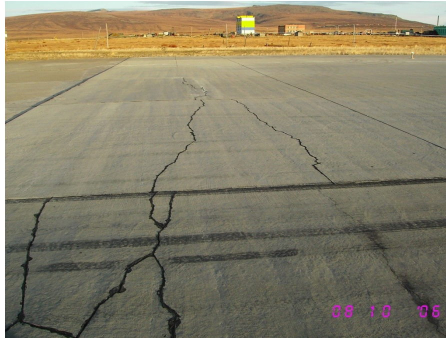
Сквозные трещины на новом покрытии ИВПП
